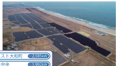
▲亶理太陽光発電所 79.5Mw
